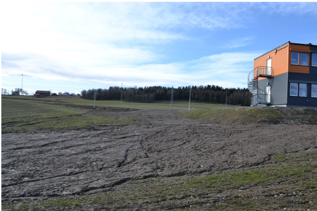
Figur 13 Omfattende erosjon på utlagt matjord ved Statens vegvesens rigg ved Nygårdskrysset, E18, Ås (Foto: Trond Knapp Haraldsen).
