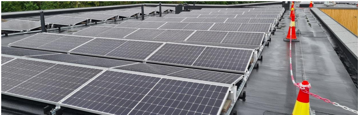
Solceller Fossliia omsorgssenter (Foto: Veidekke)
